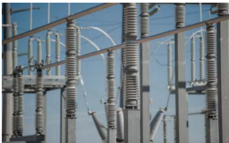
Foto: Elektroenergetski objekt. Vir: Unsplash
